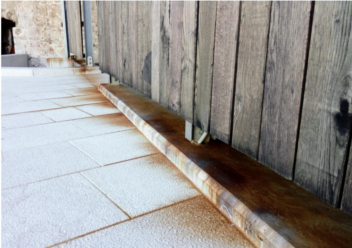
Slika 35. Korozijska i nezaštićeni drveni materijal na pozornici, rujan 2015.
