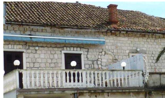
Slika 234: Kuća Koščina, zazidani lučni prozor
