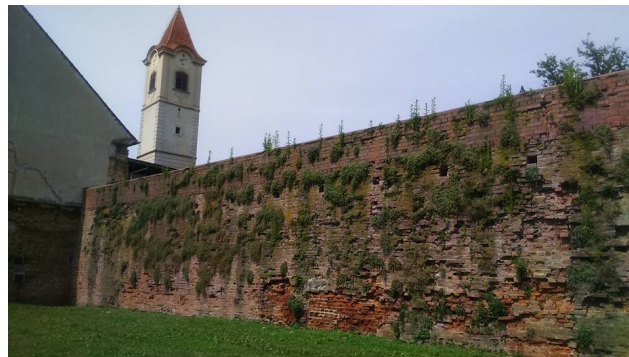
Slika 46. Današnje stanje bedema (IV. dilatacija) između ulaznog (III. dilatacija) i jugoistočnog bastiona (V. dilatacija). Na površini samih zidova izraslo je razno bilje koje oštećuje i produbljuje propadanje zida, tako da je ponovna sanacija kruništa i vanjskih površina neophodna. (foto: T. Vidović, 2016.)
